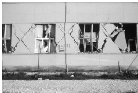
Slika 4. Budva, 1979: rušenje zidova od opeke na smicanje, [6] Figure 4. Budva, 1979: Brick wall failure due to shear, [6]
